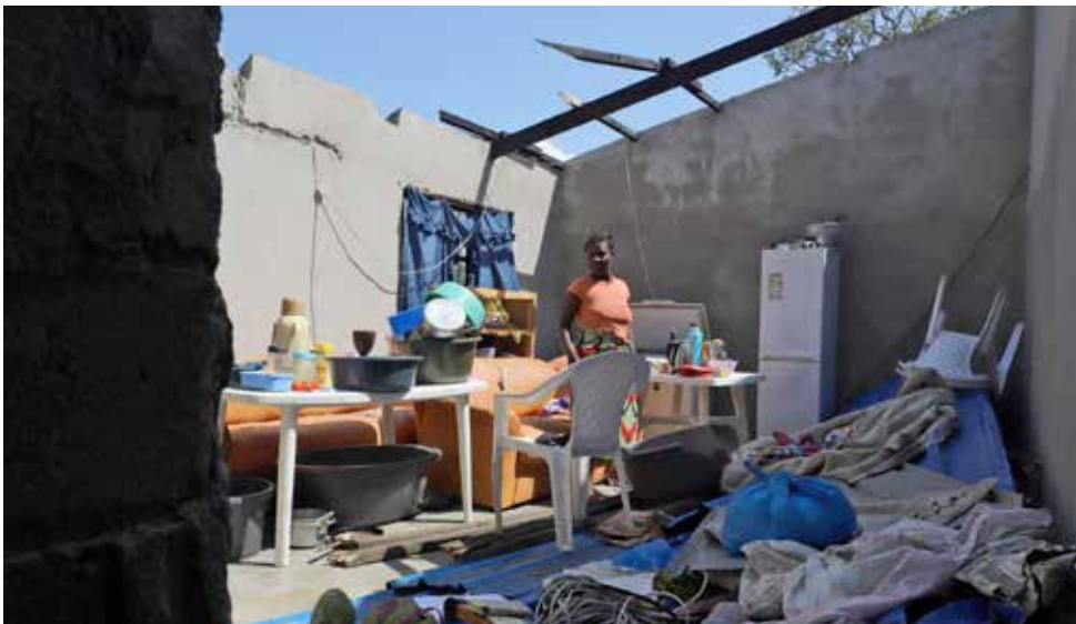
Der Sturm hat von vielen Häusern in Beira die Dächer weggerissen und Mauern einstürzen lassen.
